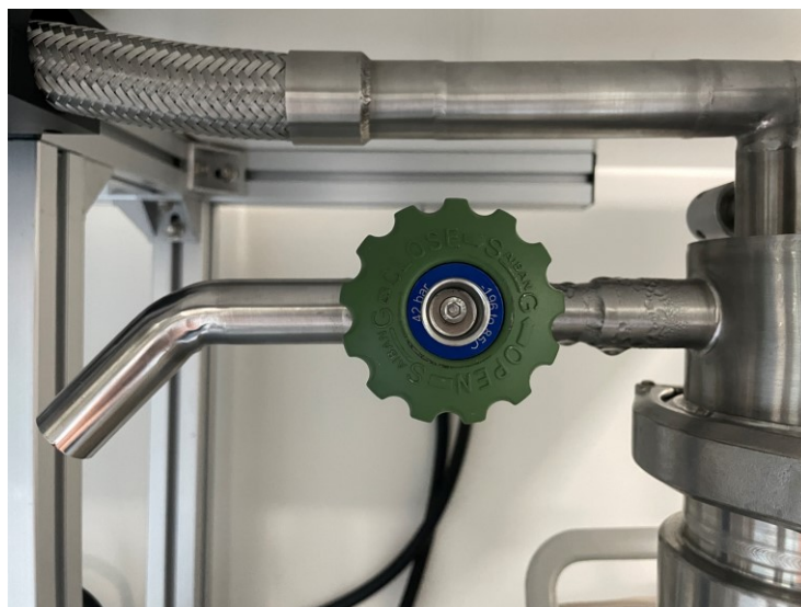
图 7-2 液氮罐排放阀顺时针关闭, 逆时针打开
