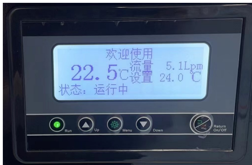
图 7-1 水冷机运行状态
